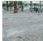
-Sòl inadequat per caminar -Moll de la fusta
