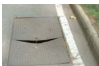
-Tapa d'instal·lacions enfonsada en carril bici. -Av/ Diagonal
