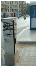
-Armari d'instal.lacions obert i escossell buit. -Cantonada Diagonal amb Pg de Sant Joan.
