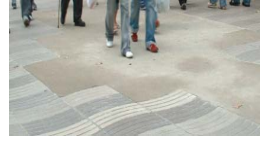
-Es reemplaça la falta de rajoles ar formigó. - Rambla
